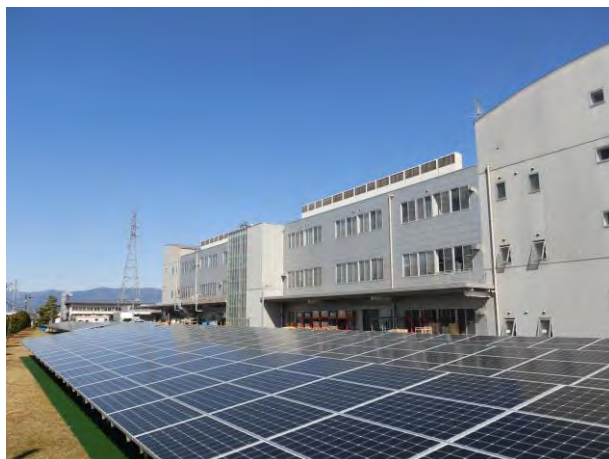
本社敷地内に設置した太陽光発電設備
