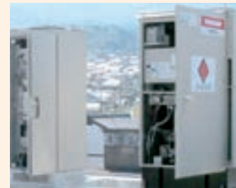
▲防災無線基地局用電源装置
